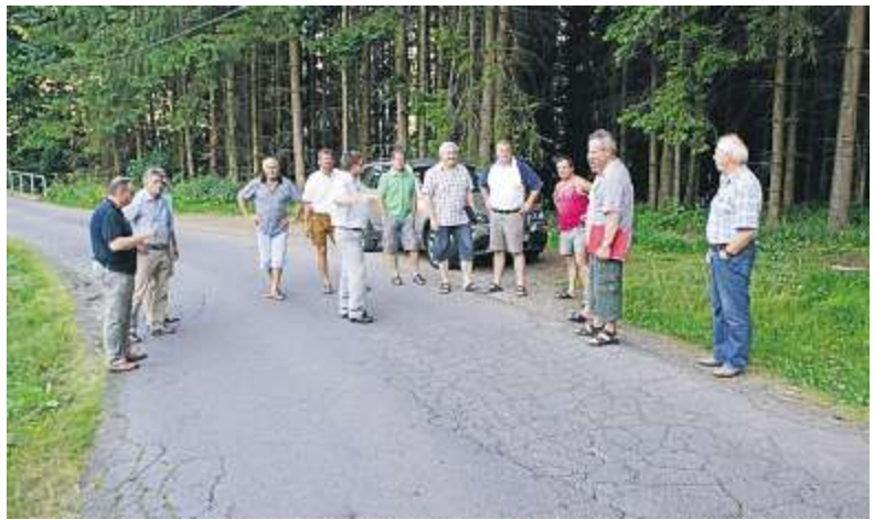
Der Winter hat auf den Gemeindeverbindungsstraßen (hier bei Hofstetten) seine Spuren hinterlassen.
