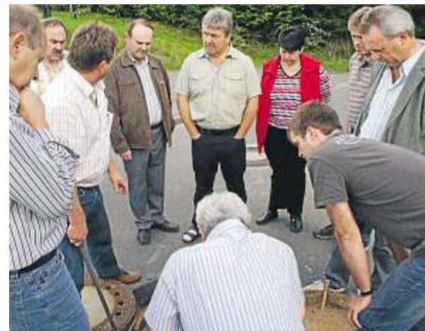
In der Birnerstraße müssen die Kanaldeckel neu justiert werden.
