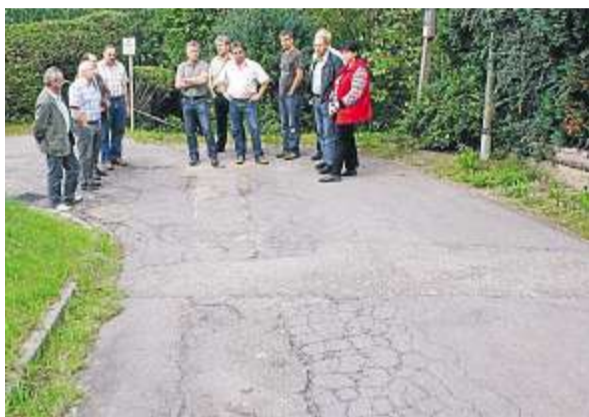
Ähnlich wie der Zustand im Friedhofweg sieht eine große Anzahl der GV-Straße aus.
