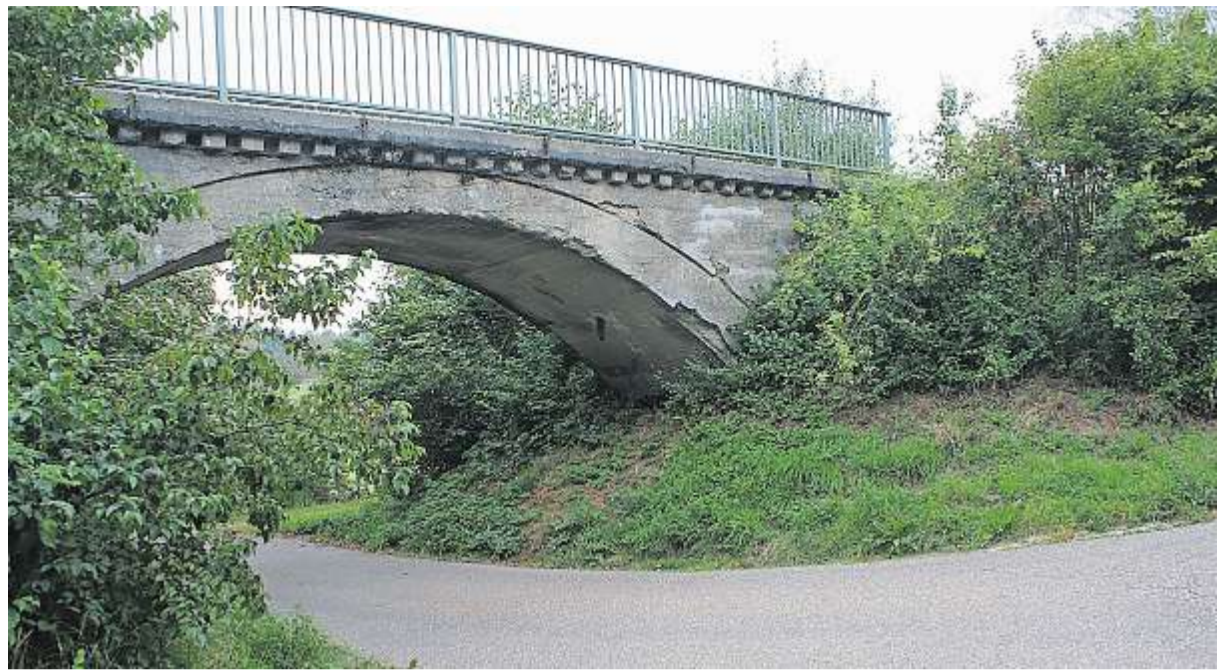
Die ehemalige Bahnbrücke bei Gfäll weist massive Schäden auf und soll aufgegeben werden. Der Radweg muss daher umgebaut werden. Foto: rfa
