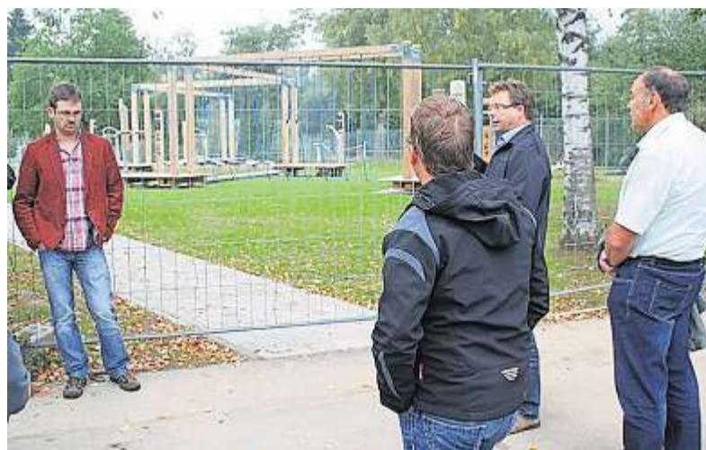
Beim Zugang zum Bewegungsparcours muss der Bürgersteig abgesenkt werden.
