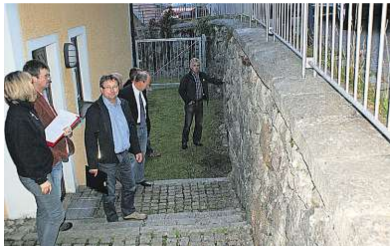
Dringender Handlungsbedarf besteht auch an der Stützmauer bei der Pfarrkirche. Fotos: rfa
