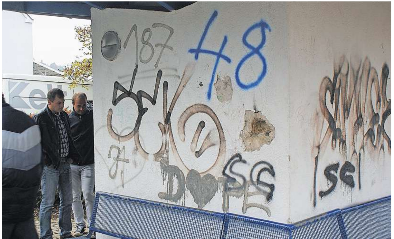
Das WC-Häuschen am Busterminal auf dem ehemaligen Bahnhofsgelände ist wahrlich arg in Mitleidenschaft gezogen worden.
